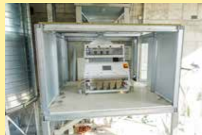
Sortieranlage für Getreide.
